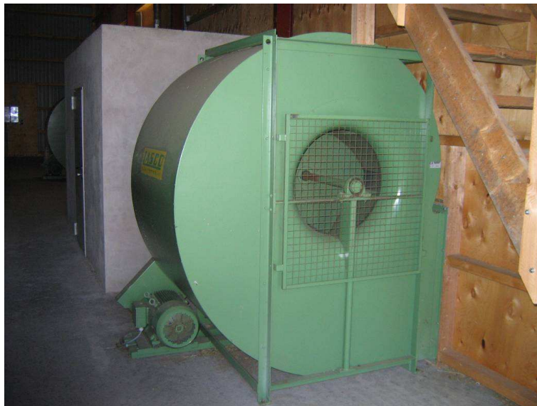
Figur 5. Den ene af de to 15 kW blæsere. Dieselgeneratoren står i rummet bag blæseren.
