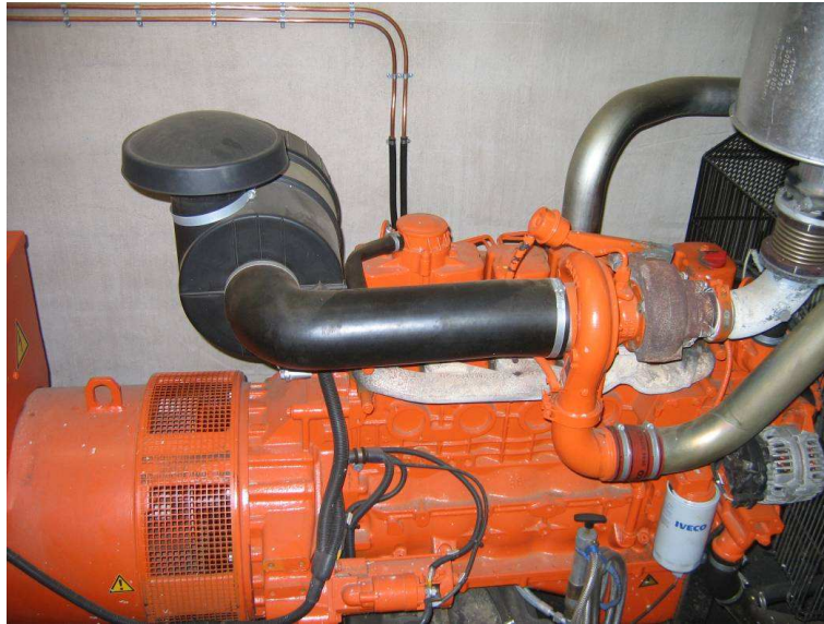
Figur 6. Diesलगenerator til drift af varmepumpe.
