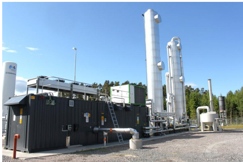
Figur 42: Vandskrubnings opgraderingsanlæg hos Swedish Biogas International i Linköping, Sverige (Kilde: Rutz)
