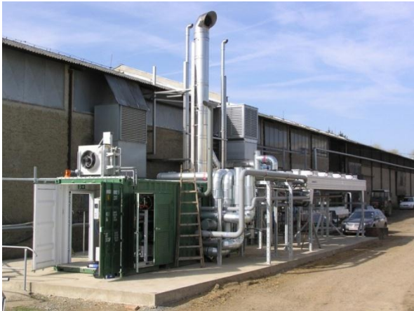
Figur 32: ORC system (bruger R245fa) på et biogasanlæg i Dublovice, Tjekkiet (Kilde: GE Energy)
