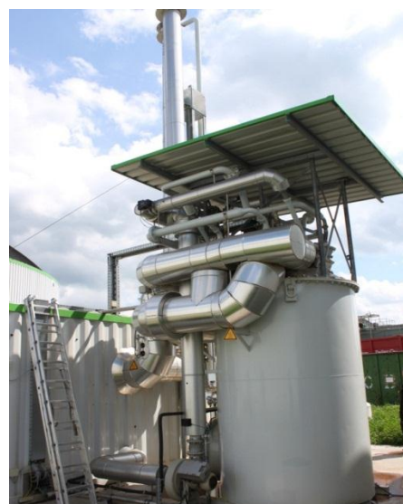
Figur 4: Lav brændværdi (LCV) brænder til opvarmning af rådnetanken på et biogas opgraderingsanlæg i Aiterhofen, Tyskland (Kilde: Rutz)
