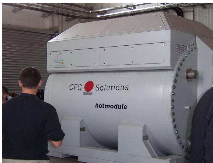
Figur 3: Molten Karbonat Brændselscelle (MCFC) til biogas i Leonberg, Tyskland (Kilde: Rutz)
