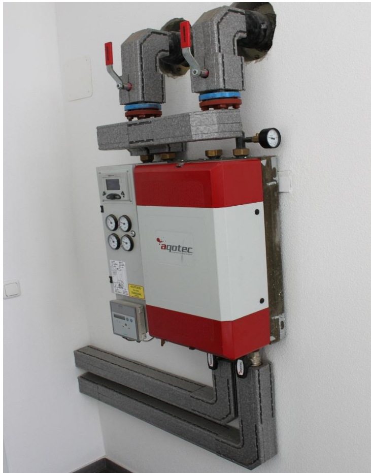
Figur 11: Tilslutningsudstyr (inklusiv en varmeveksler) hos en slut-forbruger tilsluttet fjernvarmesystemet i Achental, Tyskland (Kilde: Rutz)
