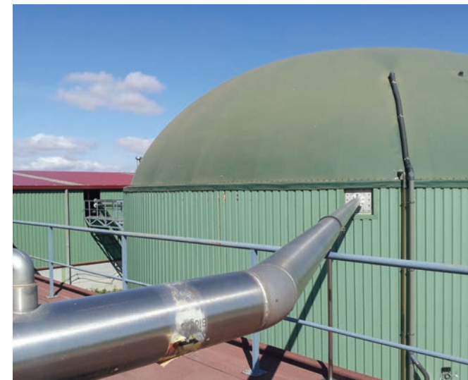
Foto: Michael Tersbøl Biogasanlæg er avancerede anlæg og skal bestå af robust teknik til at håndtere fast biomasse.
